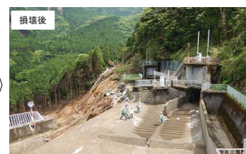
①ヘッドタンク・余水路損壊状況（撮影：H28.5.15）
