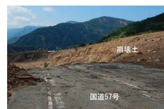
④国道57号被災状況(撮影:H28.5.20)
