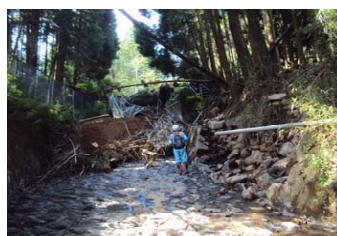
②余水路損壊・閉塞状況（撮影：H28.5.18）
