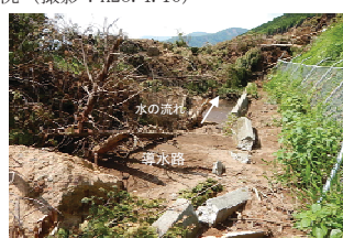
②導水路閉塞状況(撮影:H28.5.21)
