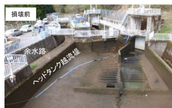
ヘッドタンク・余水路損壊前状況（撮影：H22.4）
