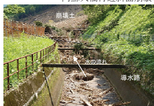
①導水路閉塞状況(撮影:H28.5.20)
