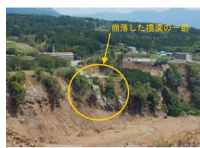
③阿蘇大橋被災状況(撮影:H28.5.20)
