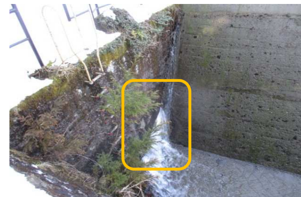
写真② 漏水状況
