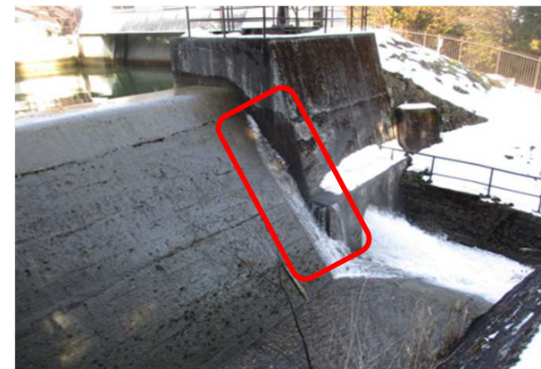
写真① 漏水状況
