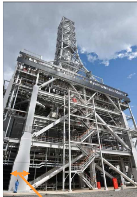
【写真1】排熱回収ボイラー 支持鉄骨の太さ2.6m
