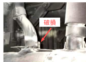
節炭器中間管寄せ（前側缶後） 吊下管管台溶接部破損
