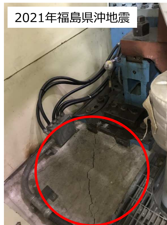
上図，蒸気タービン 第3軸受台グラウト部 割れ写真
