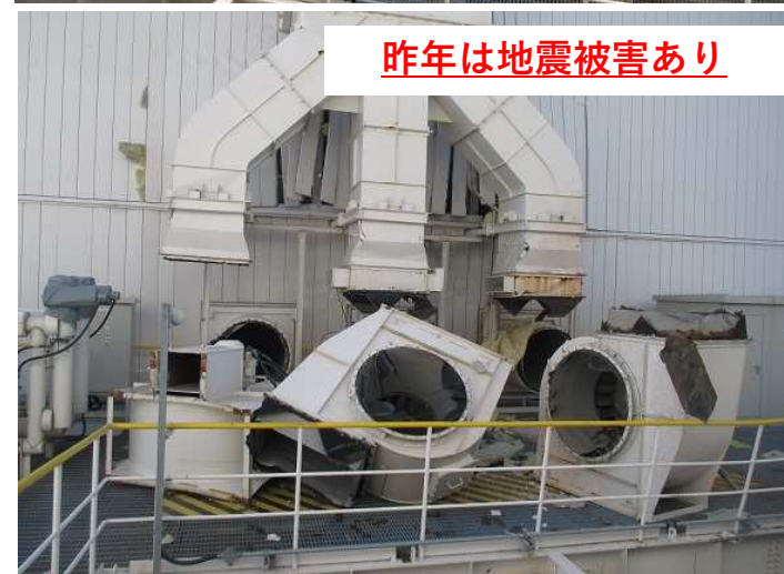
写真2：2021.2.13福島県沖地震での転倒状況
