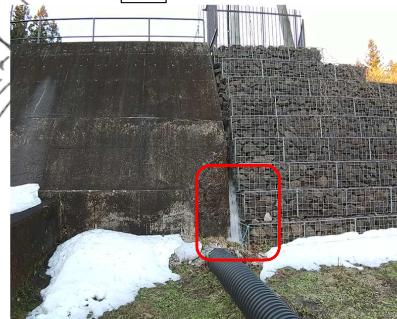
写真 漏水状況
