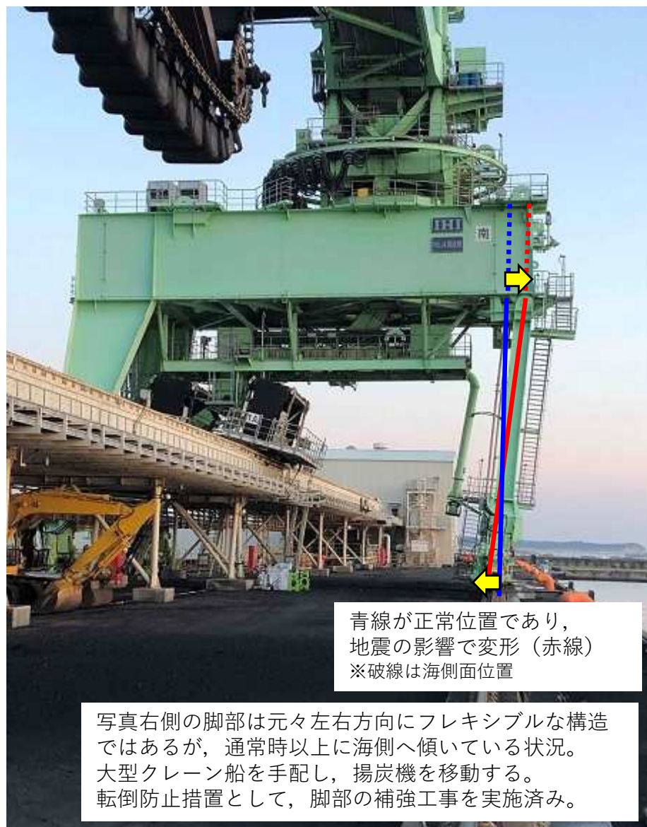
揚炭機脚部損傷状況
