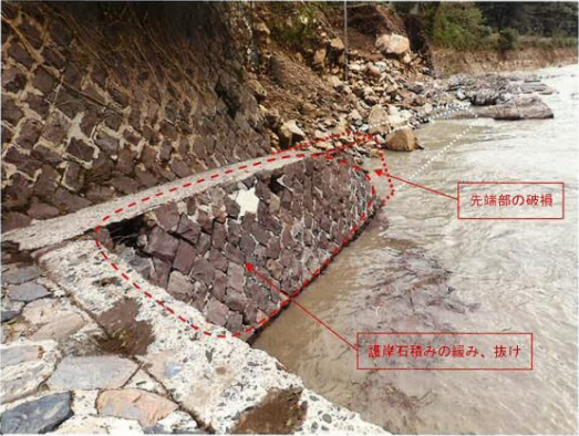
放水口導流壁（宮崎県西米良村）
