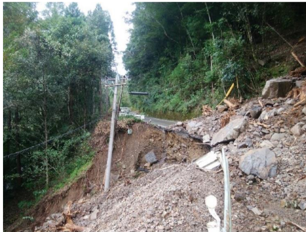
土砂災害による被害（宮崎県西都市県道39号）
