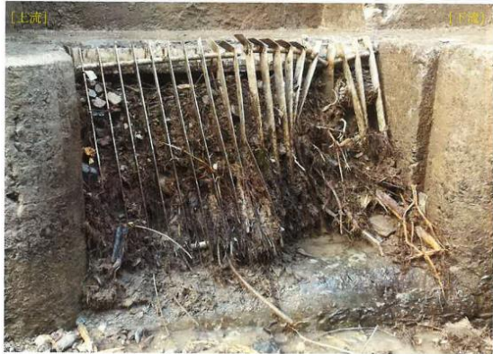
取水口除塵設備（宮崎県椎葉村）
