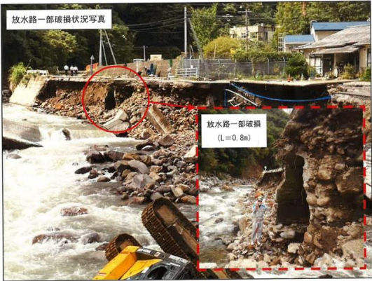
放水口（大分県由布市）
