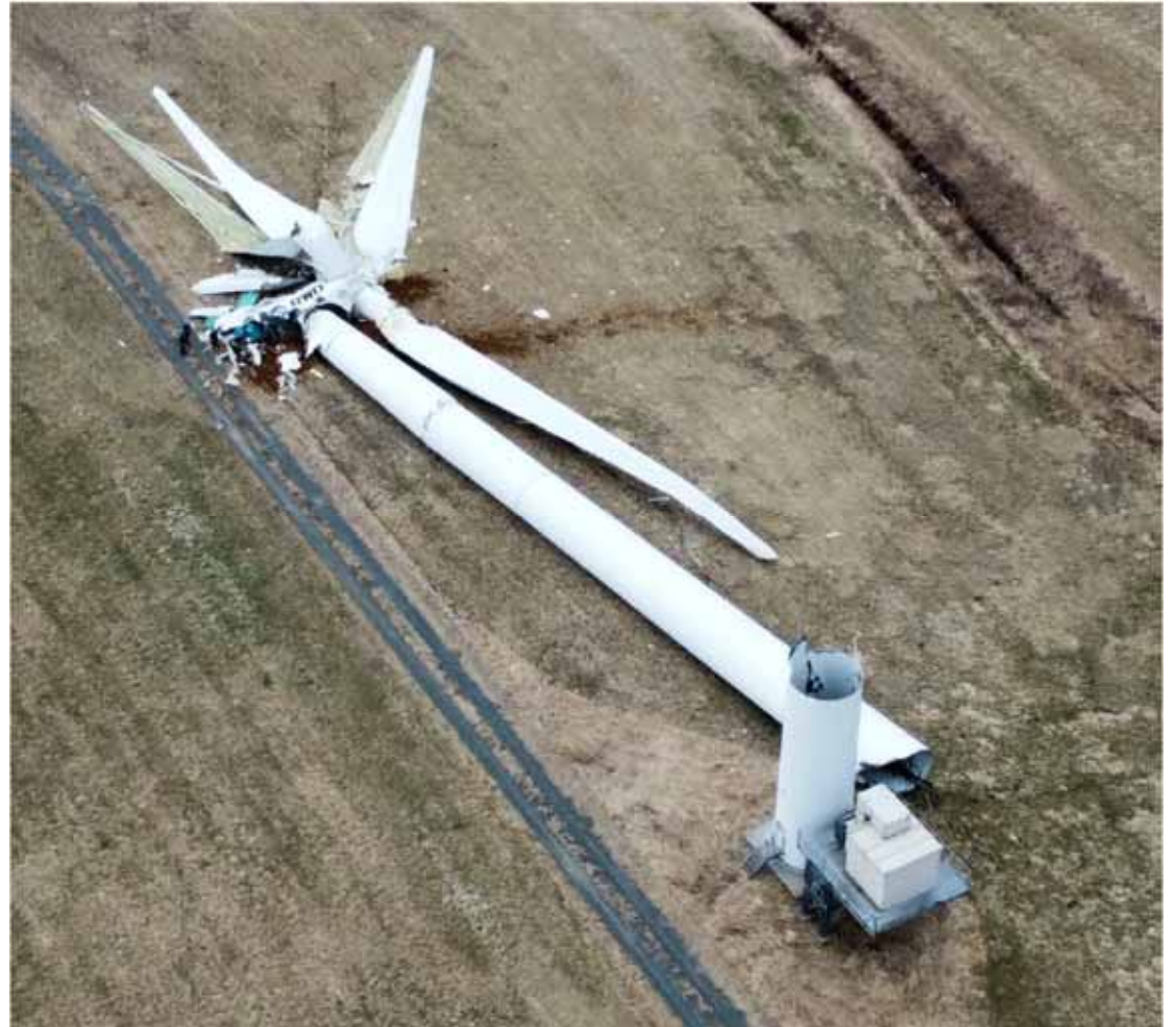
図1-4. 事故時の上空からの状況写真
