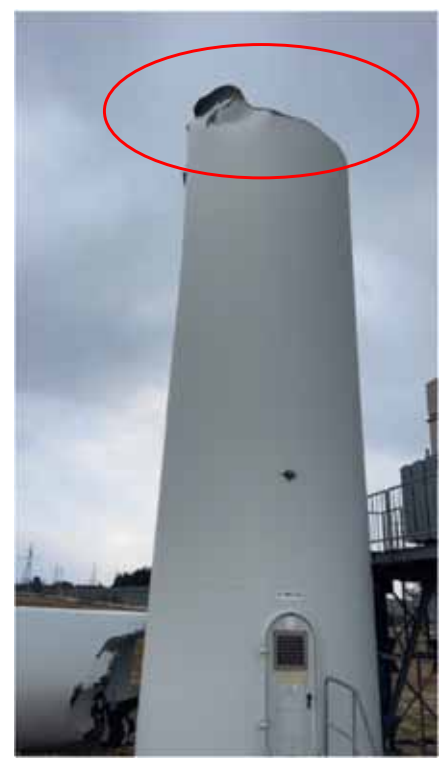
損傷タワー下部残存部
