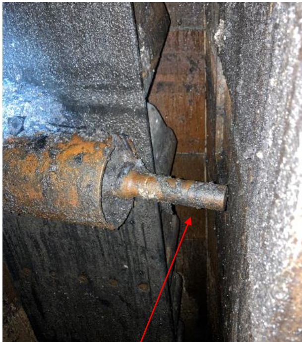
プーリーが外れている
