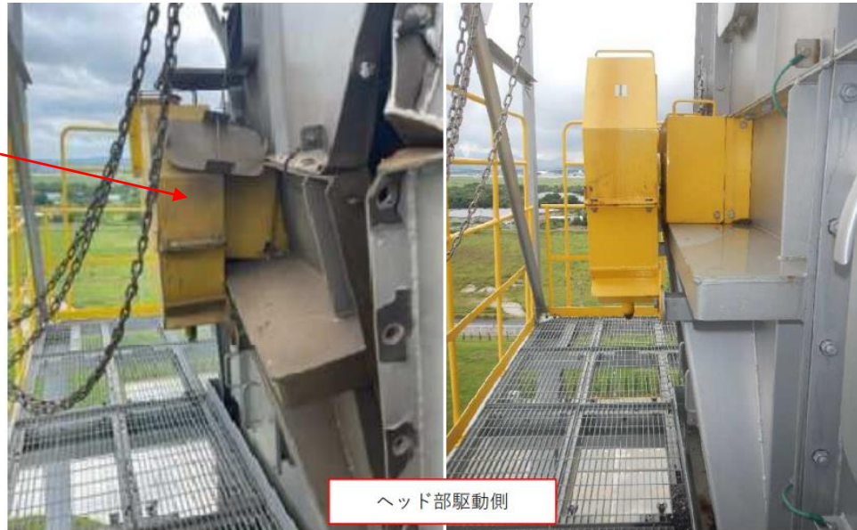
B側（損壊側）
