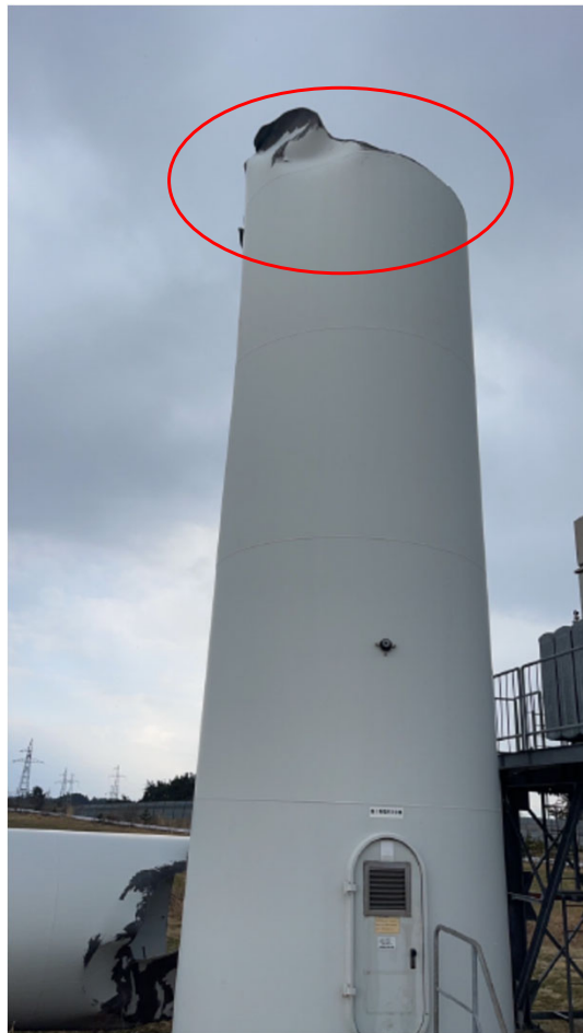
損傷タワー下部残存部
