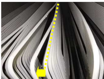
1，2号ボイラー三次過熱器管 配列乱れ
