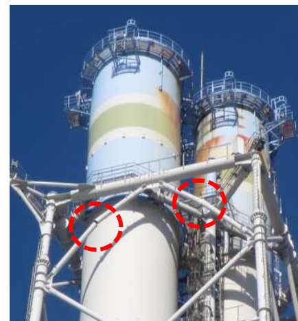
煙突 支持鉄塔斜材 一部座屈・破断
