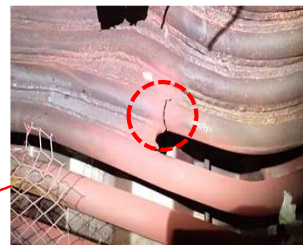
2号ボイラー水冷壁管 割れ
