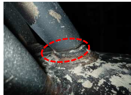
1号ボイラー一次過熱器入口管寄せ取付管 割れ
