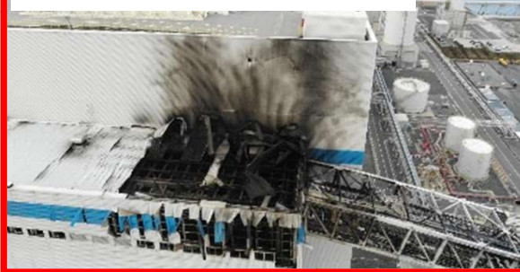
Aバunk付近 爆発による損傷
