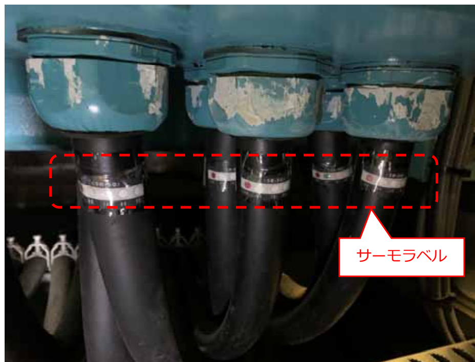
発電機ケーブル取込口
