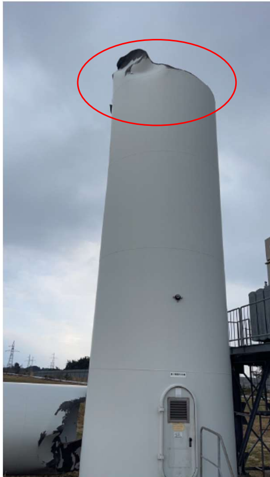
損傷タワー下部残存部
