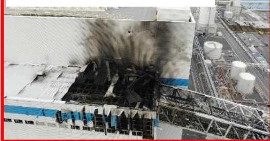
Aバunk付近 爆発による損傷
