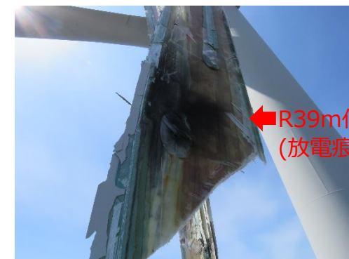
写真3: 破損したブレードCの近接写真 プレッシャーサイド内側
