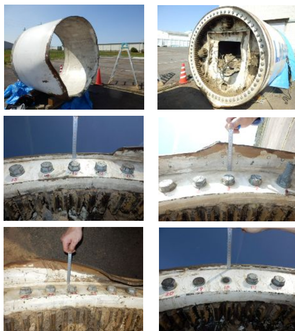
写真3 タワーとナセル側の破断状態
