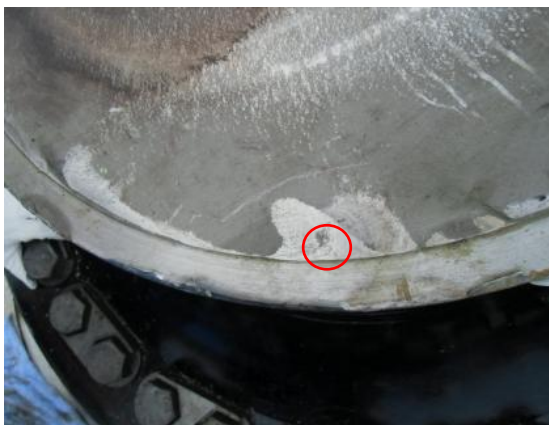
亀裂起点 C
