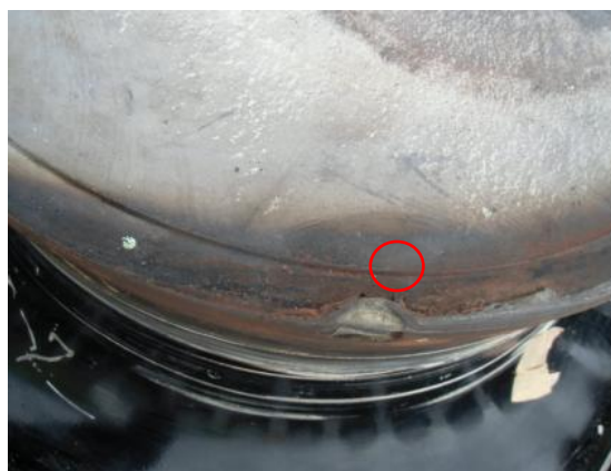
亀裂起点 A
