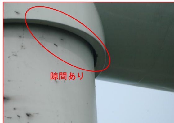
図 3-12 ナセル(発電機側隙間)
