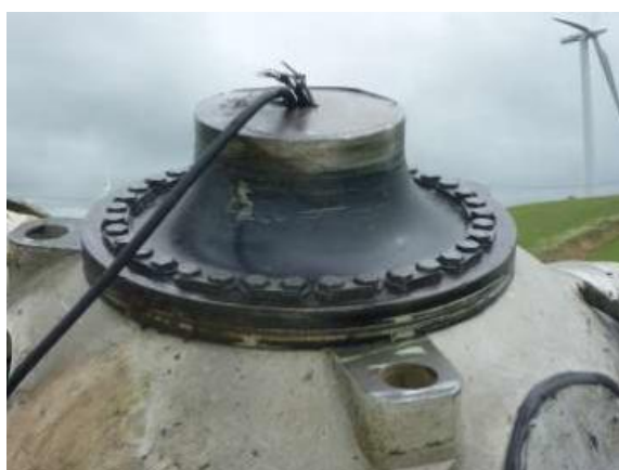
図 1-6 ロータハブ落下状況(主軸破断状況)
