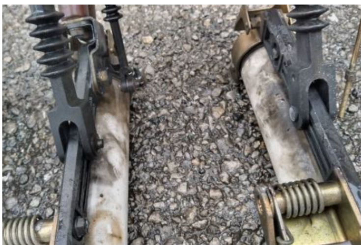
塩害により絶縁が低下し、復電後に 焼損した高圧交流負荷開閉器(LBS)
