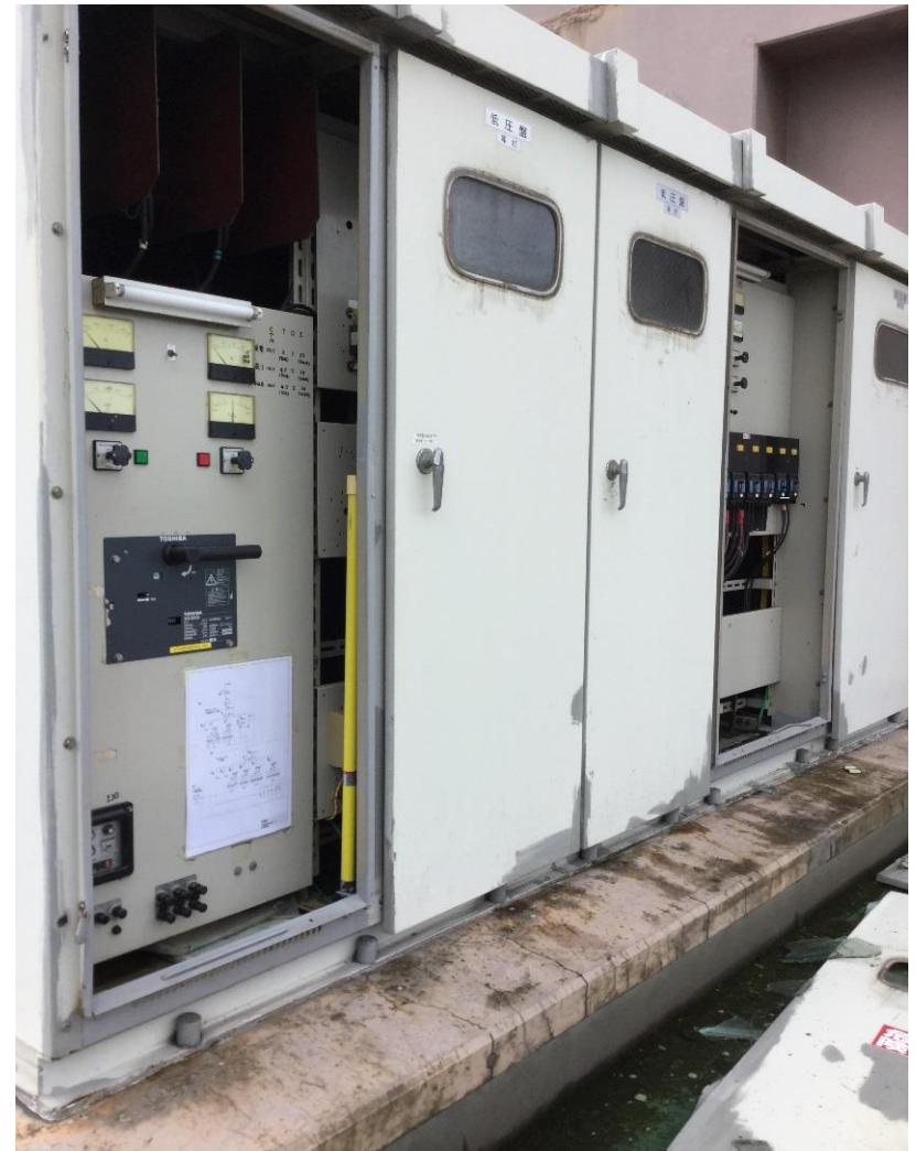
受電設備の扉破損
