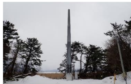
小形風力の設備落下
