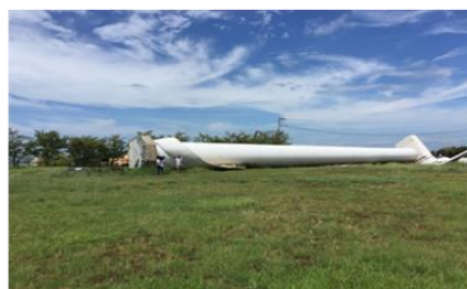
風力発電設備の倒壊
