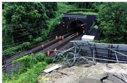
小出力太陽電池の崩落
