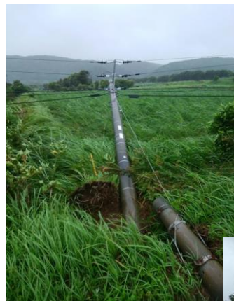
倒壊した電柱
