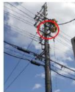
写真1 波及事故発生現場
