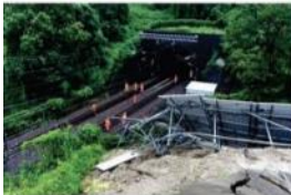
小出力太陽電池の崩落
