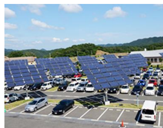
追尾型太陽電池発電設備
