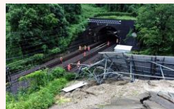
<太陽光パネルの崩落>
