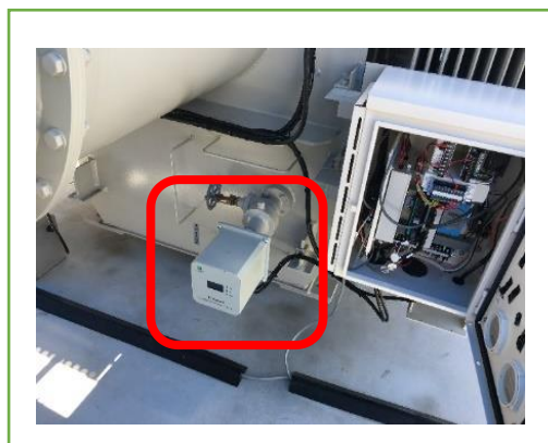
図-7 変圧器廃油弁に設置した油中ガス分析器
