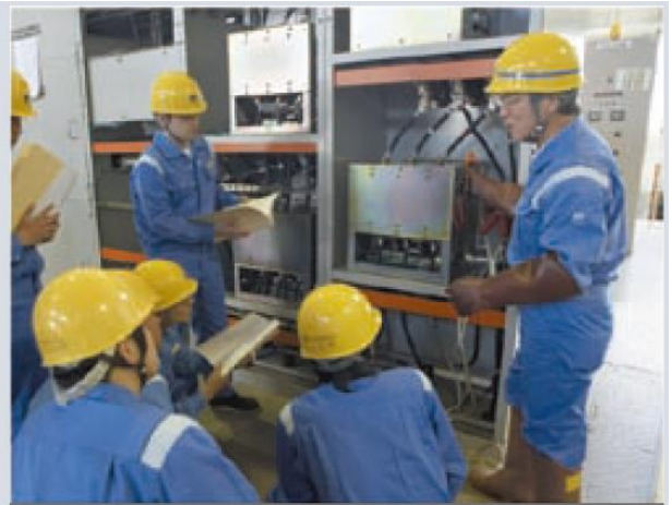
高圧受変電システム
