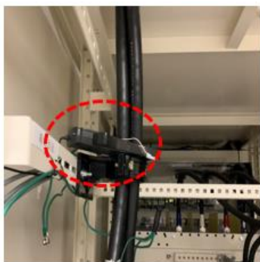
ZCT (漏洩値計測)
