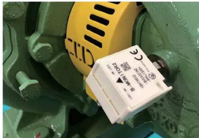
図 12 西島製作所製ポンプにセンサを設置した状態
