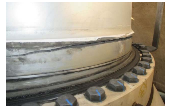
図 2-1 ハブ側に残ったアルミニウムリングと亀裂
