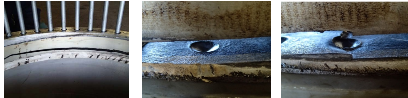
(1) アルミニウムリングの外観とクラックの状況 (2) クラック／ボルト孔底部拡大図（ところどころに大きな段差）
