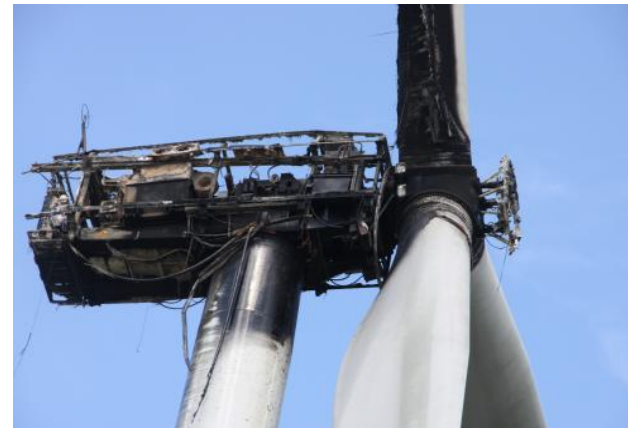
図5 火災事故(鎮火後)
