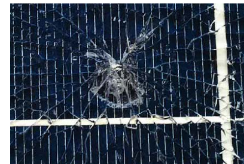
↑ 飛来物によるガラス割れ
