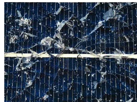
↑ 外部応力によるガラス割れ
