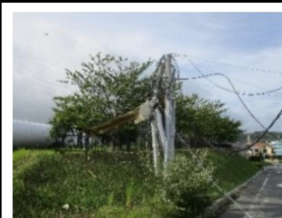
図1-9 構内柱①（折損）
