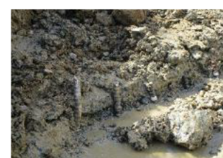
図1-5 鉄筋破断 （フーチング上面）
