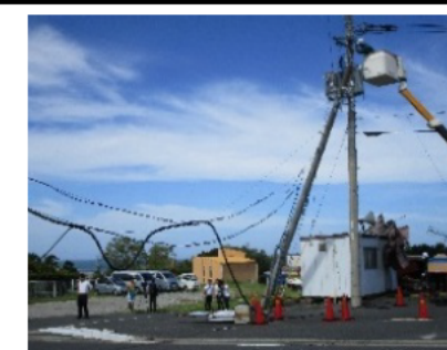
図1-10 構内柱②（倒伏）
