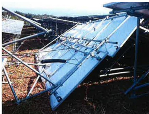
台風の強風により架台倒壊
