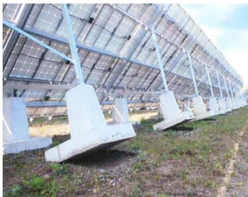
台風による後面からの風圧により、架台の後部が持ち上がり、アレイ全体が前傾
