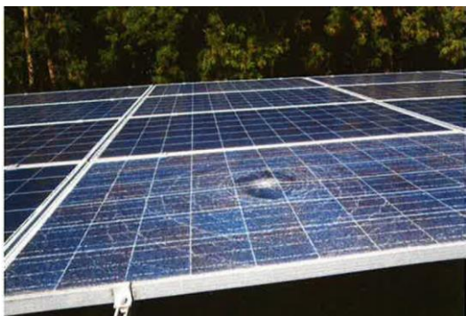
台風による飛来物によりパネルが破損
