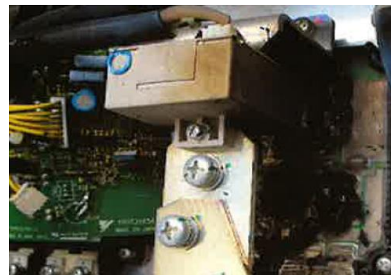
パワーコンディショナーの短絡・焼損
