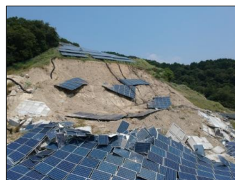
太陽光パネル崩壊事故（2018年7月、姫路市）
