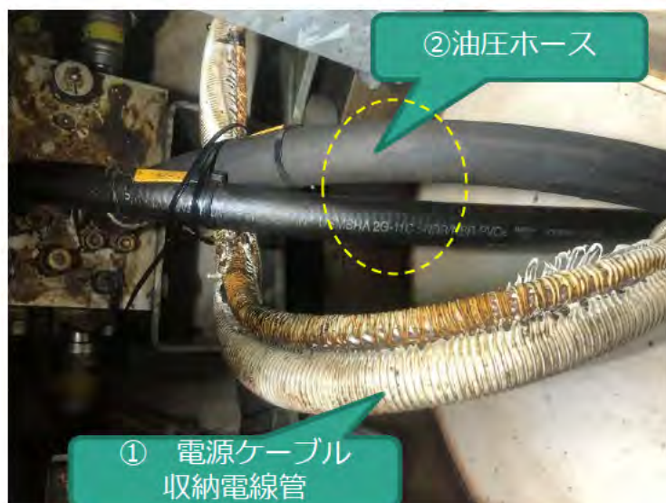
主軸～ハブ制御盤までの電源ケーブル
