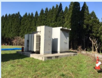
サイトキュービクル など被害なし
