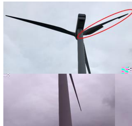
13号風車:ブレード1枚破損
