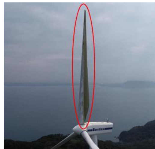
7号風車:ブレード1枚破損
