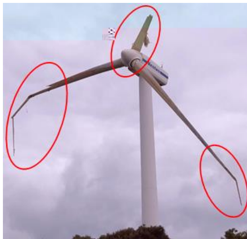
8号風車:ブレード3枚破損
