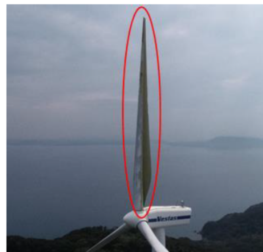
7号風車:ブレード1枚破損
