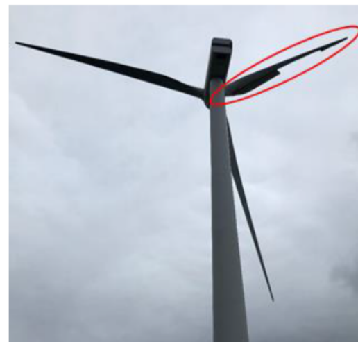
13号風車:ブレード1枚破損
