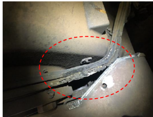
ブレーキ過熱により損傷した制御線
