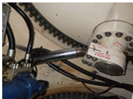
接続部が折れたシリンダシャフト
