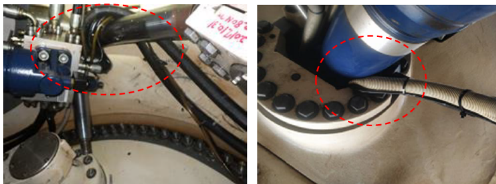
破損したピッチシリンダがハブ内の配線などを押しつぶしていた
