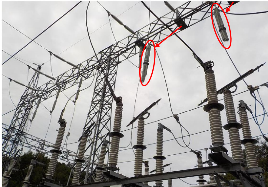
電線支持碍子破損状況写真（中国電力提供）
