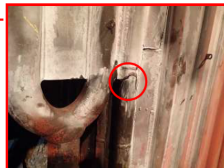
1号機:ボイラー管損傷状況
