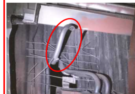
2号機:ボイラー管損傷状況②
