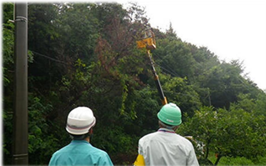
高圧線に倒れた木を伐採
