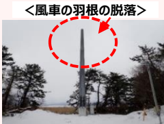
<風車の羽根の脱落>
