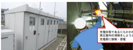
【図1】キュービクル（高圧受電設備） 【図2】変電室の感電死傷事故のイメージ※実際の事故画像ではありません。
