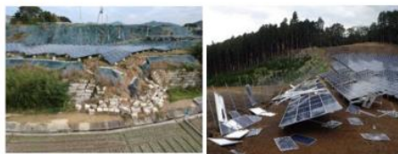
【図1】台風の大雨による事故被害 【図2】台風の強風による事故被害 出典：「地上設置型太陽光発電システムの設計ガイドライン2019年版」（国土交通省） 出典：「電力安全小委員会の各期における検討状況等について」（経済産業省 第22回産業構造審議会 保安・消費生活用製品安全分科会 電力安全小委員会）
