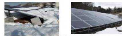
【図1】積雪による太陽電池発電設備の破損 出典：「地上設置型太陽光発電システムの設計ガイドライン2019年版」（国土交通省） 出典：「電力安全小委員会の各期における検討状況等について」（経済産業省 第22回産業構造審議会 保安・消費生活用製品安全分科会 電力安全小委員会）
