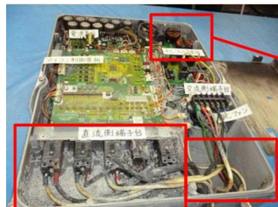
PCSの焼損事故の例
