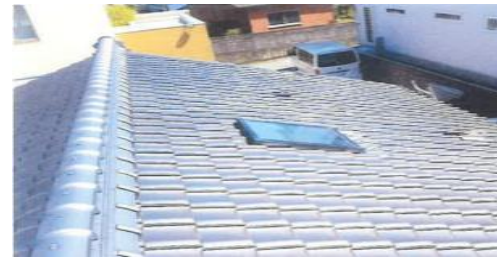
屋根上に飛散したモジュール
