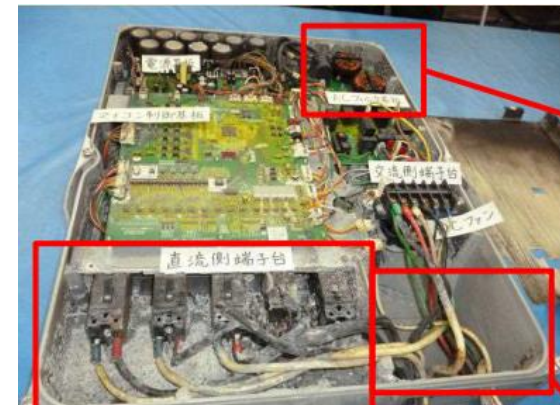
PCSの焼損事故の例
