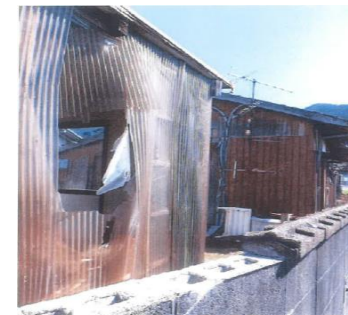
破損した民家
