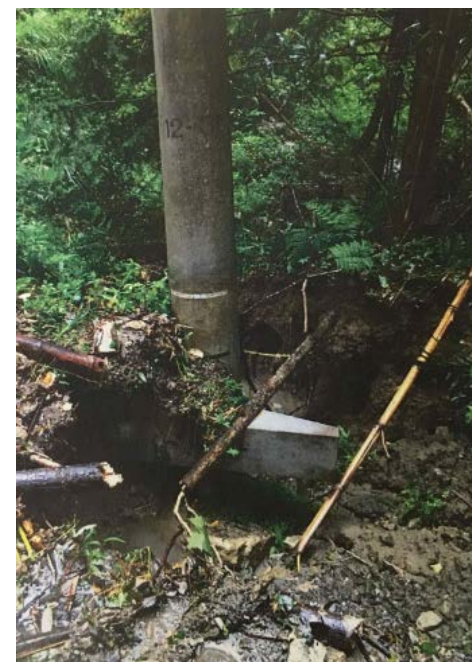
地盤の影響による電柱傾斜（茂原エリア）
