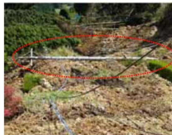
〔熊本県阿蘇地方〕 地盤の影響（崖崩れ等）
