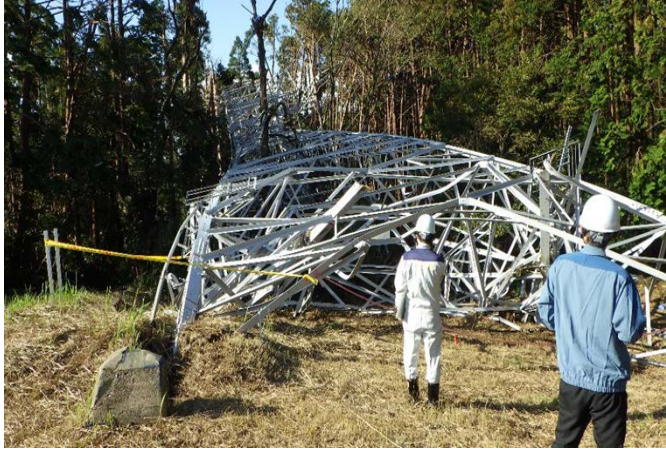
<倒壊した鉄塔（No.78）>
