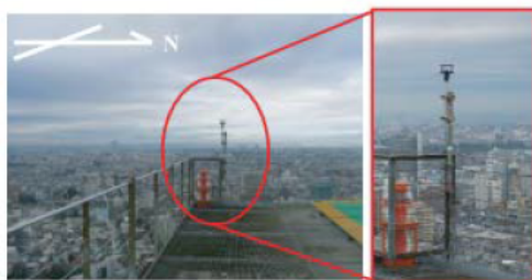
（風向・風速計の設置状況）
