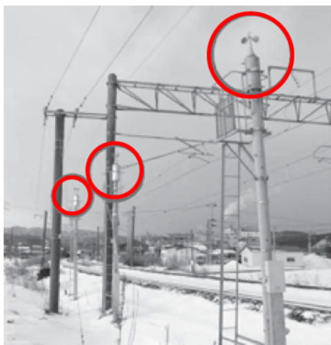
（羽越本線での風速計の設置状況）
