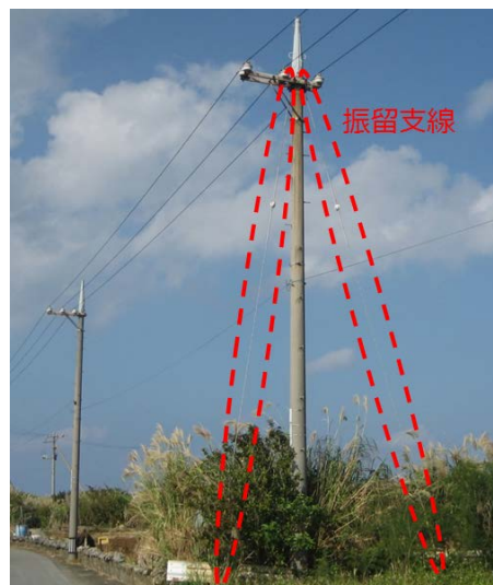
＜支線事例（沖縄電力）＞
