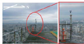
(風向・風速計の設置状況)
