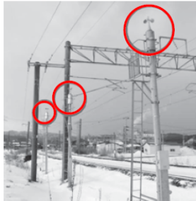
(羽越本線での風速計の設置状況)
