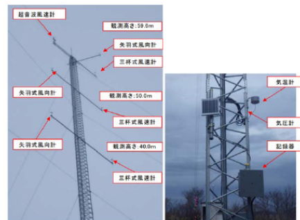
(観測機器の設置写真)
