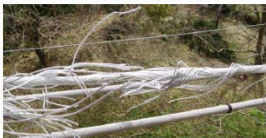
写真⑦ 内房線2L上相 電線
