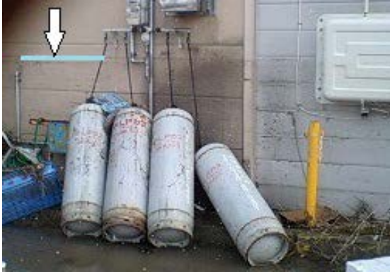
かろうじて高圧ホースで止まっている (メーターの下まで津波がきている)
