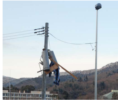
高圧ホースにより電柱に残った容器 (2011 年 3 月 23 日付「石巻かほく」)
