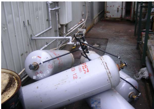
流された勢いで供給管が引きちぎられた (伊藤工機株式会社提供)
