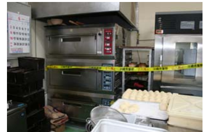
※（現場写真）業務用オーブン
