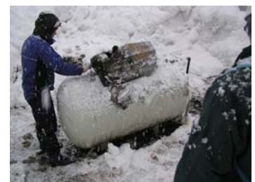
※（現場写真）バルク貯槽
