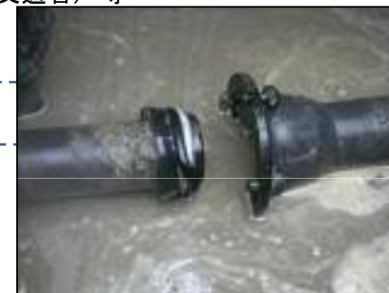
<液状化により損傷し、閉塞した導管の例>
