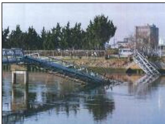
＜漂流物の衝突により損傷した導管の例＞
